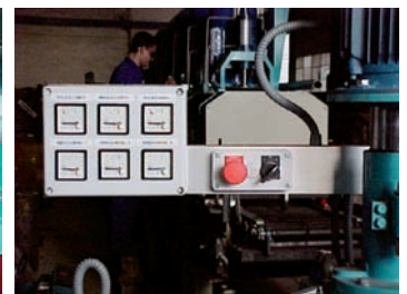
Sistema de Control
